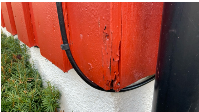
Råteskade i hjørnebord.
