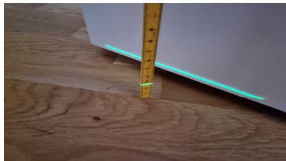
Kontroll av planavvik.
