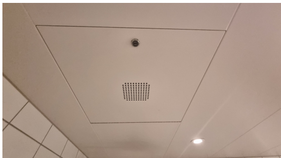
Fordelerskap plassert i himling på bad.
