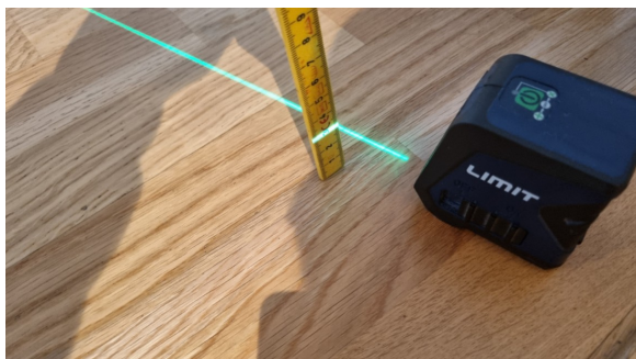
Kontroll av planavvik.
