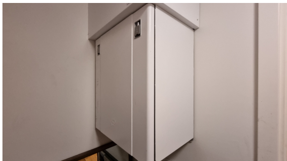
Boligen har balansert ventilasjon via ventilasjonsaggregat med varmegjennvinning.
