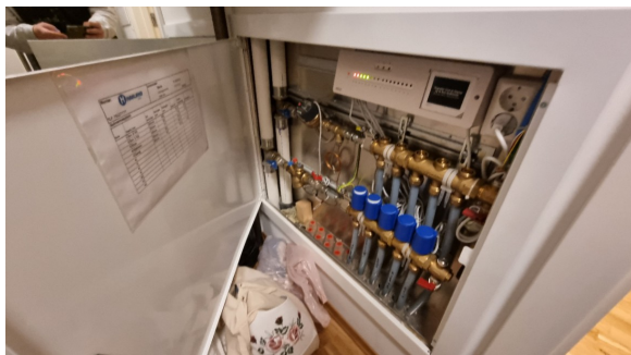
Fordelerskap for vannbåren gulvvarme.
