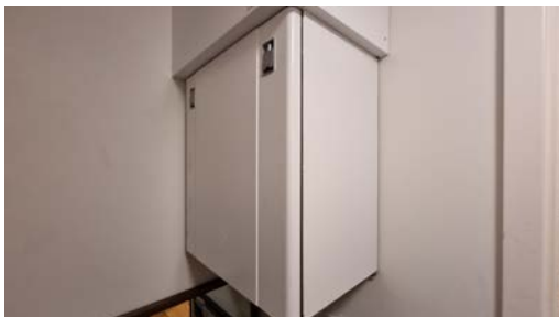
Boligen har balansert ventilasjon via ventilasjonsaggregat med varmegjennvinning.
