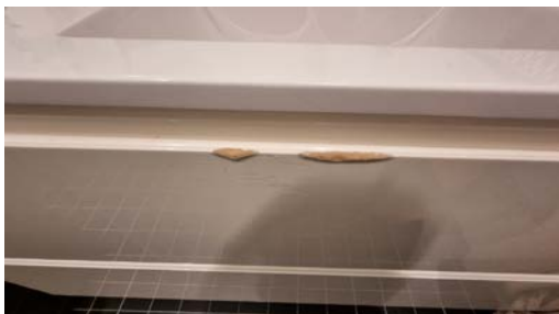
Fuktsvell i skuffefront.
