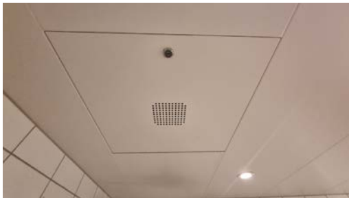
Fordelerskap plassert i himling på bad.
