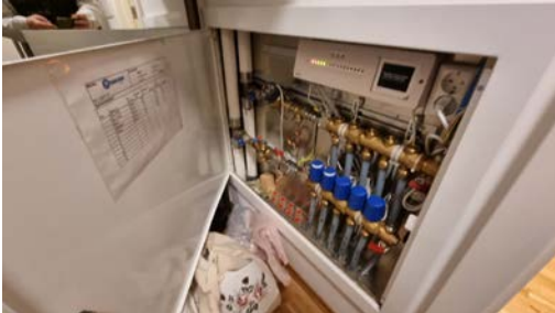
Fordelerskap for vannbåren gulvvarme.
