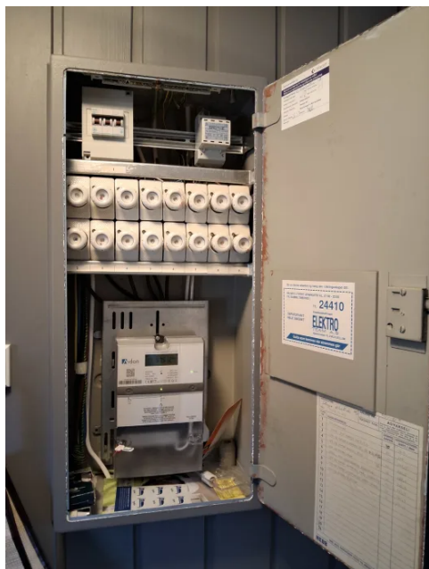
Sikringsskap er plassert i entré.
