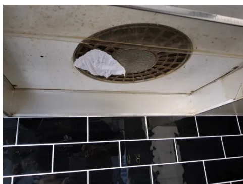
Avtrekkseffekt er testet med papir.
