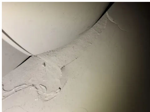
Gulvbelegg er skadet.
