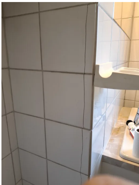
Sprekker i veggfliser.
