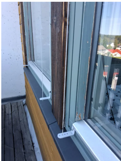
Vinduskarmer er værslitt.
