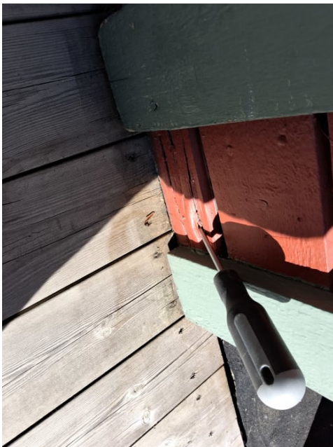
Råteskadet kledning på bod.
