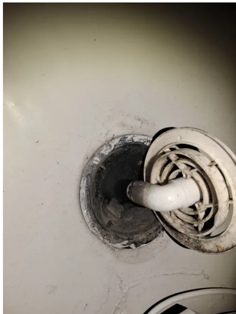
Overgang mellom sluk/membran kan ikke verifiseres.
