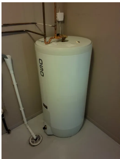
Varmtvannsbereder er plassert i vaskerom.
