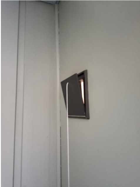
Naturlig tilluft fra klaffventiler.
