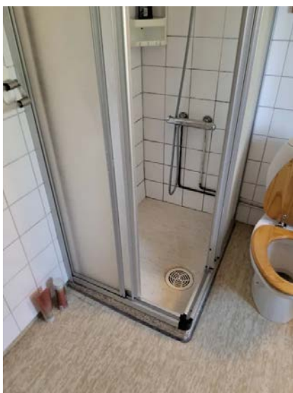
Sluk er isolert i dusjsonen.
