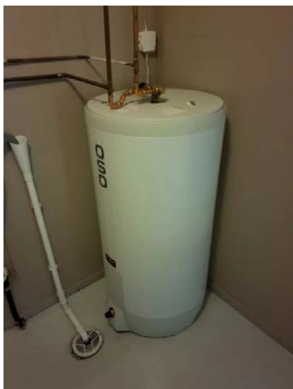
Varmtvannsbereder er plassert i vaskerom.
