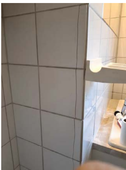
Sprekker i veggfliser.
