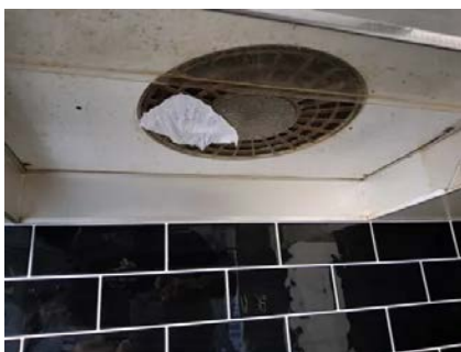
Avtrekkseffekt er testet med papir.
