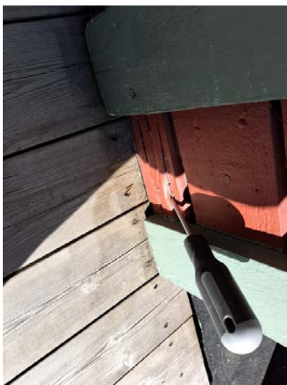
Råteskadet kledning på bod.
