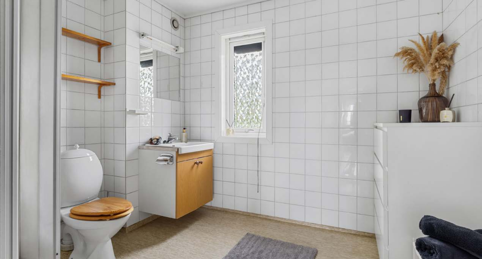
Romslig bad med belegg på gulvet og fliser på veggene. Badet har behov for oppgradering.
