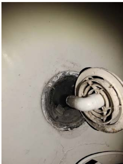
Overgang mellom sluk/membran kan ikke verifiseres.
