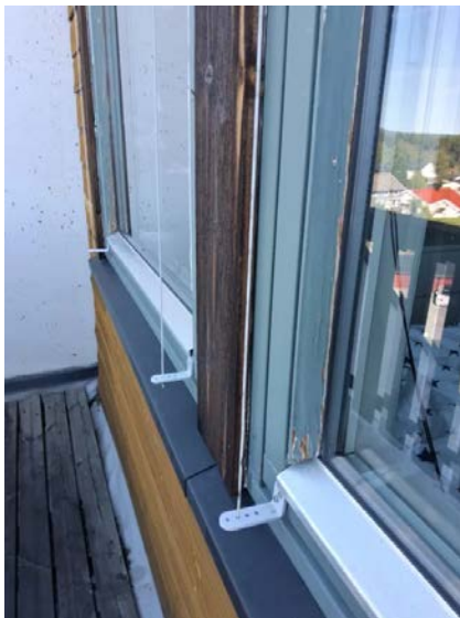
Vinduskarmer er værslitt.
