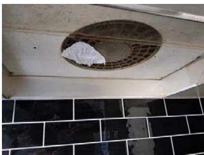
Avtrekkseffekt er testet med papir.
