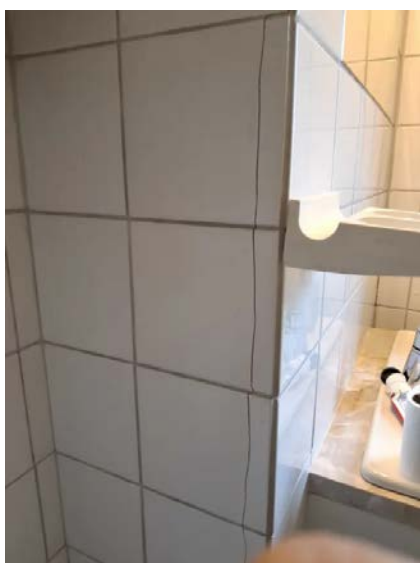
Sprekker i veggfliser.
