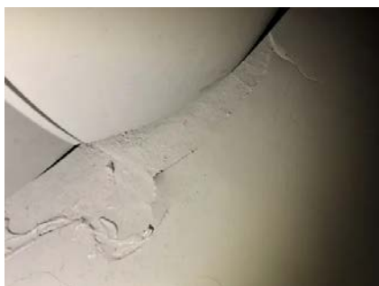
Gulvbelegg er skadet.
