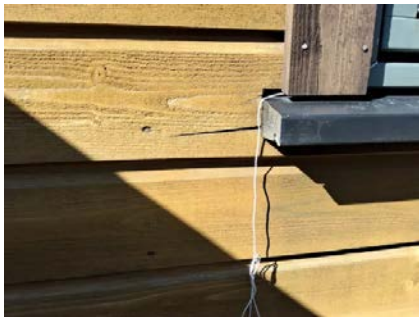
Det registreres stedvise sprekker i kledningsbord.
