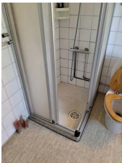
Sluk er isolert i dusjsonen.
