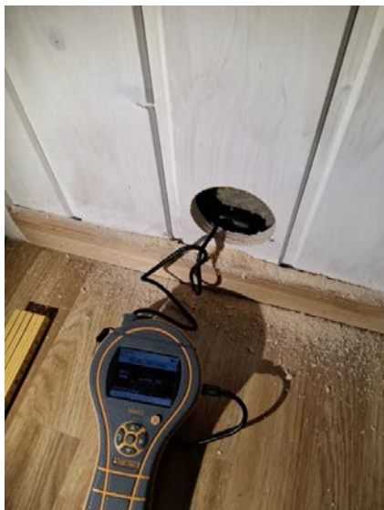
Bilde fra fuktmåling i veggkonstruksjon tilstøtende våtrom.
