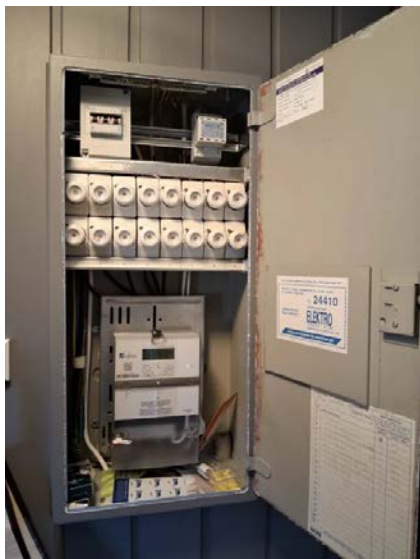
Sikringsskap er plassert i entré.
