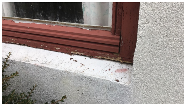
Råteskader i nedkant
