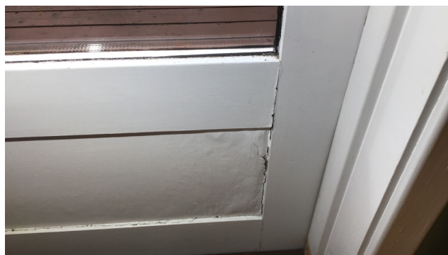
Fukt skader innside balkongdør i stue
