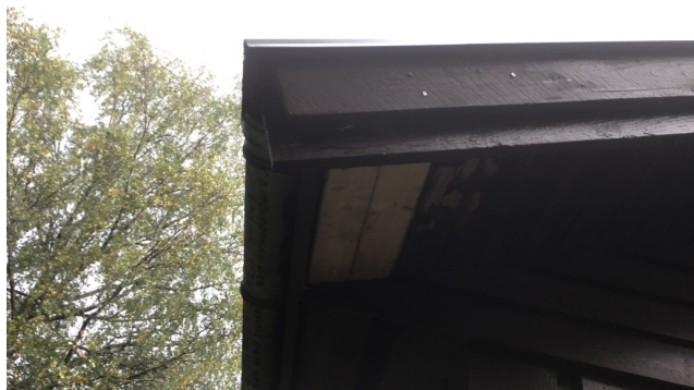
Råte i nedkant tak og i vindskie
