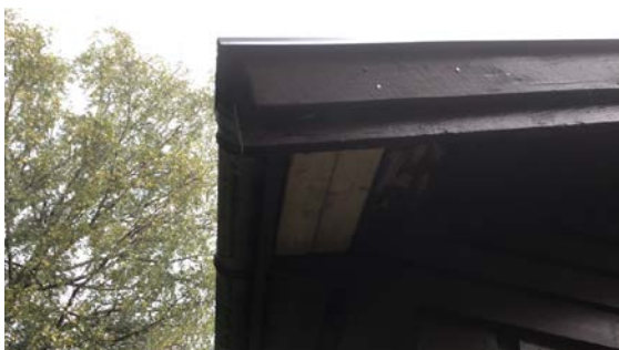
Råte i nedkant tak og i vindskier
