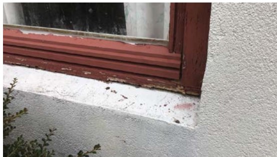
Råteskader i nedkant
