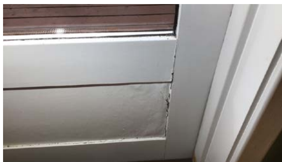
Fukt skader innside balkongdør i stue
