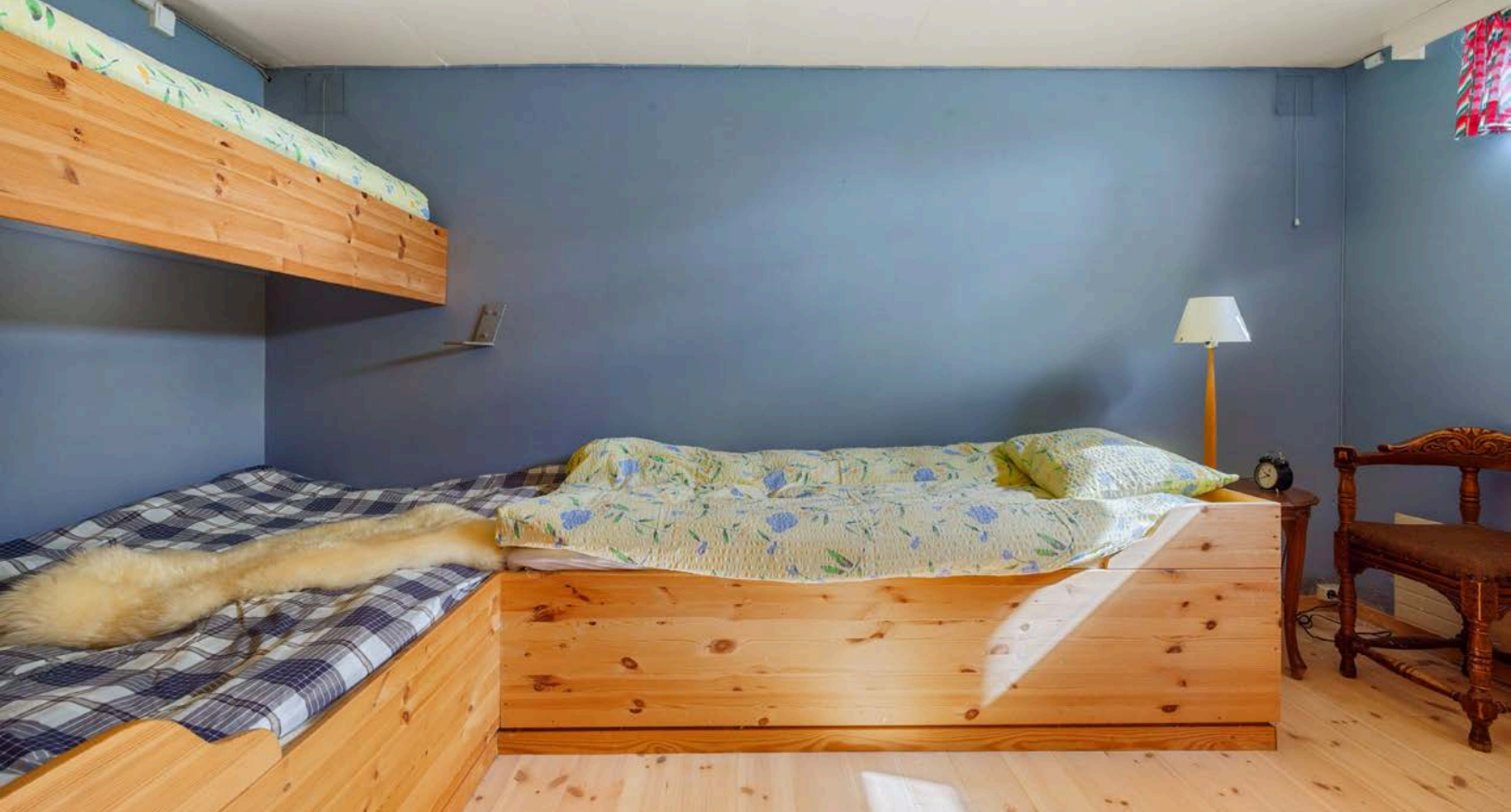
Rom i kjeller som er innredet som gjesterom. Rommet har for små vinduer til at disse er godkjente som rømningsveier. Rommet er derfor ikke godkjent til varig opphold.
