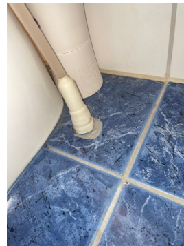
Ufaglig tetting rundt rørgjennomføring i gulv.
