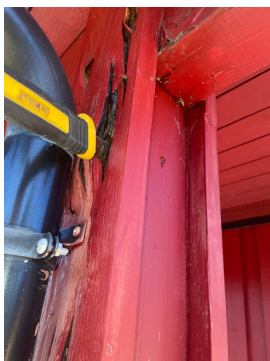
Råteskader i bærende konstruksjon.
