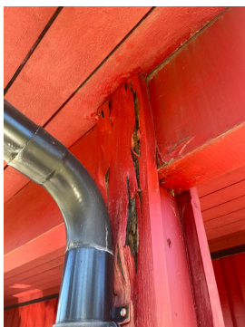
Råteskader i bærende konstruksjon.
