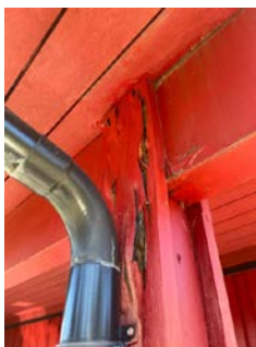
Råteskader i bærende konstruksjon.
