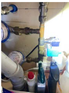
Stoppekran og vannmåler på kjøkken
