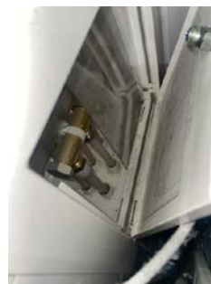
Fordelerskap for vannrør i vegg på bad.
