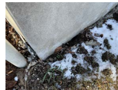
Ikke synlig fuktsikring av grunnmur.
