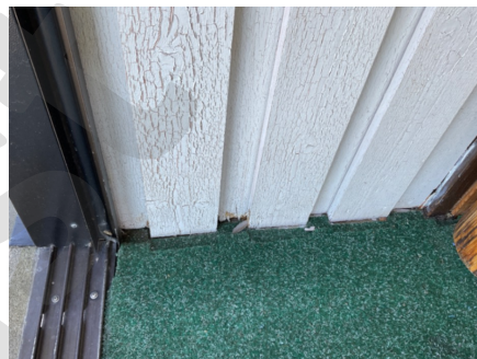
Råte nederst på kledning
