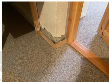
Pussavskalling på kjellervegg
