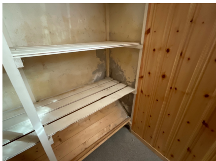
Saltutslag og avskalling på kjellervegg
