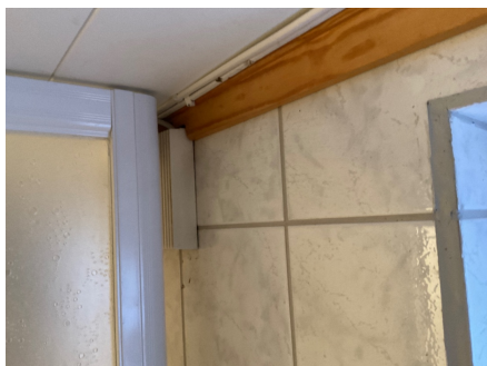
Ventilasjon bak dusjkabinett
