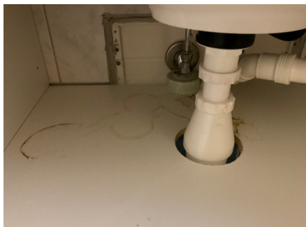
Lekkasje fra vannlås i servant skap.
