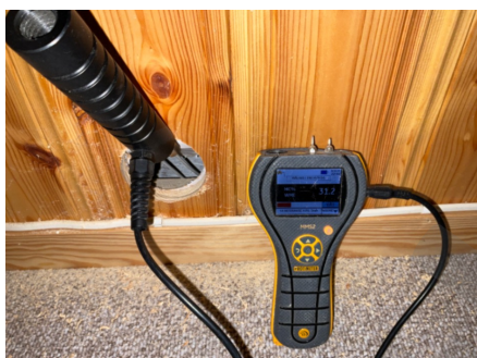
Fuktmåling i utforet kjellervegg
