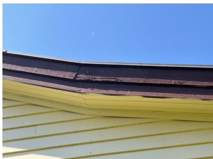
Vindskier med sprekker og slitasje.
