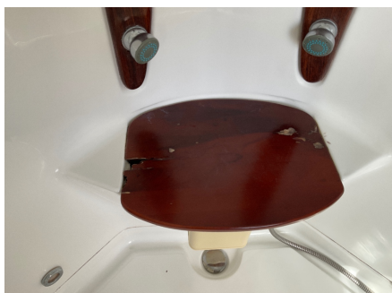
Skade på sitteplate i dusjhjørne.
