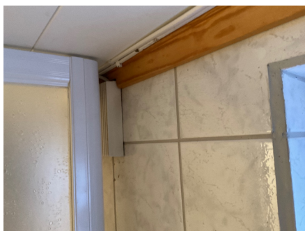
Ventilasjon bak dusjkabinett
