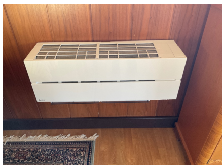
Luft til luft varmepumpe.
