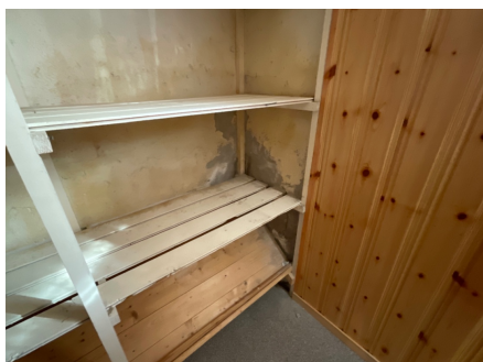
Saltutslag og avskalling på kjellervegg
