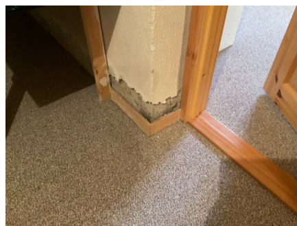
Pussavskalling på kjellervegg
