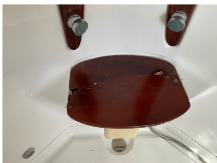
Skade på sitteplate i dusjhjørne.
