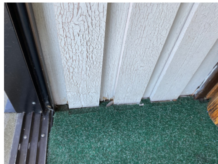
Råte nederst på kledning
