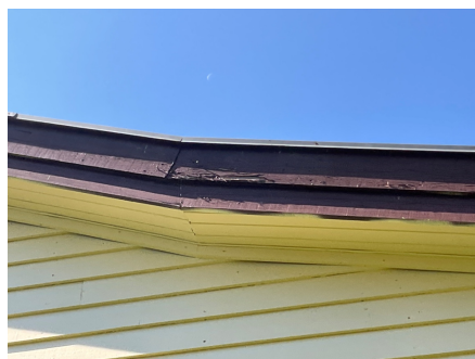
Vindskier med sprekker og slitasje.
