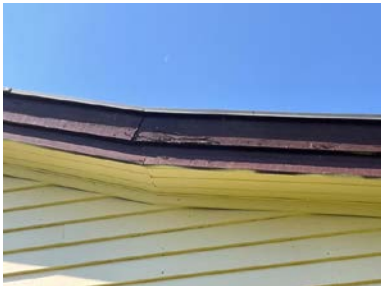
Vindskier med sprekker og slitasje.
