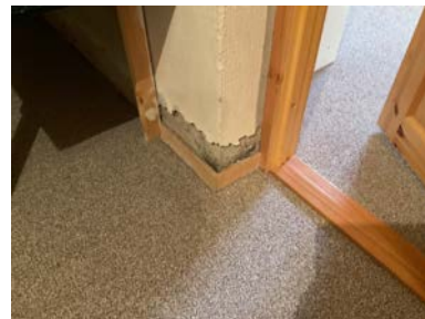
Pussavskalling på kjellervegg
