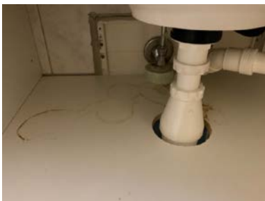
Lekkasje fra vannlås i servant skap.
