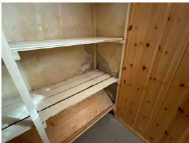
Saltutslag og avskalling på kjellervegg
