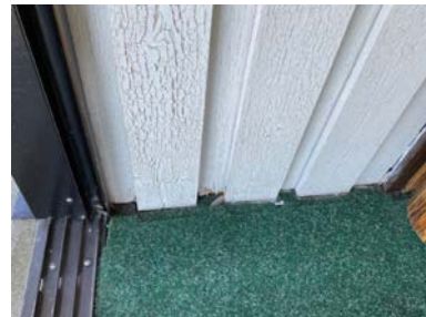
Råte nederst på kledning
