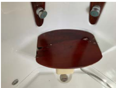
Skade på sitteplate i dusjhjørne.
