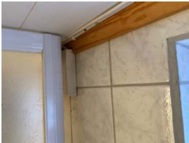
Ventilasjon bak dusjkabinett
