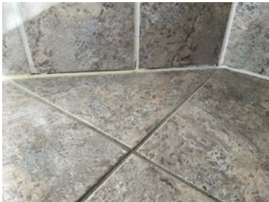
Sprekk i fuger i overgang mellom gulv og vegg
