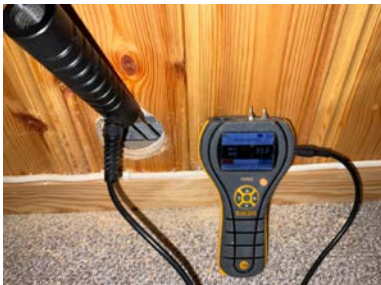
Fuktmåling i utforet kjellervegg
