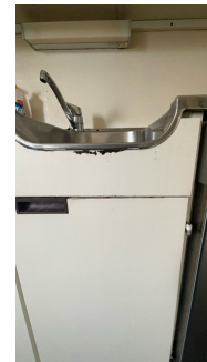
Kjøkkeninnredning bærer preg av slitasje.
