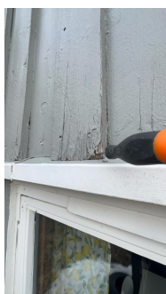
Det er påvist spredte råteskader i bordkledningen.
