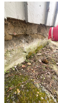
Malingsflass, avskalling og saltutslag på vegg, dette indikerer fuktvandring i vegger.
