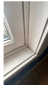
Punktskader og svelling i utforing.
