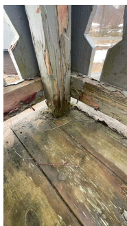
Det er værslitt/oppsprukket trevirke/trepaneler.
