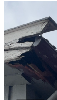
Det er påvist fukt-/råteskader i takkonstruksjonen.
