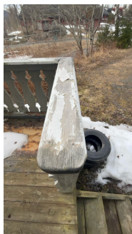
Det er værslitt/oppsprukket trevirke/trepaneler.
