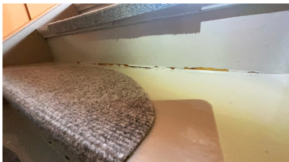
Slitasje på trapp.
