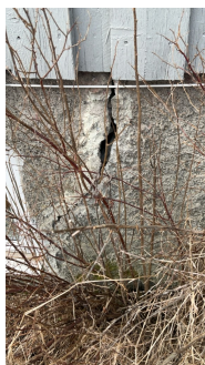
Sprekker/riss ble registrert på grunnmur.
