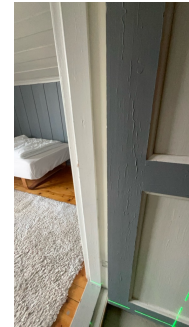
Dørene bærer preg av bruksslitasje, men ivaretar funksjonskrav.
