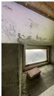
Malingsflass, avskalling og saltutslag på vegg, dette indikerer fuktvandring i vegger.
