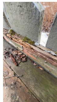
Det er påvist fukt-/råteskader i konstruksjonen.
