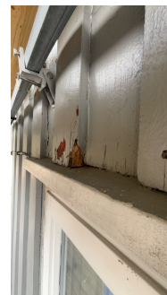
Kledning er ført ned på vannbrett, risiko for fuktoptrekk.
