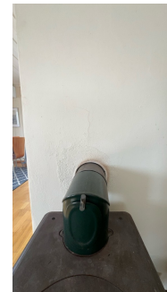
Det er påvist sprekker og/eller riss i pipe.
