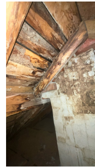
Synlige fuktmerker. Det er usikkert om fuktmerker skyldes eldre eller nyere vanngjennomtrengning. Tilgjengelige merker var tørre på befaringen.
