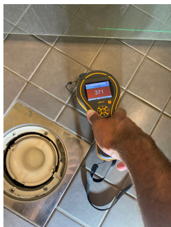
Fuktsøk med forhøyede verdier rundt sluk.
