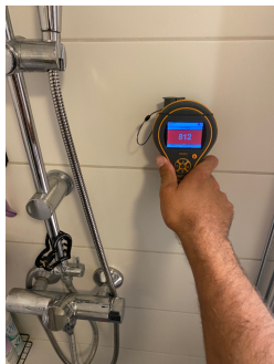
Fuktsøk med forhøyede verdier på dusjvegger.
