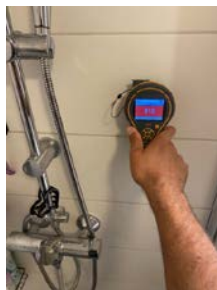
Fuktsøk med forhøyede verdier på dusjvegger.
