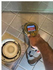
Fuktsøk med forhøyede verdier rundt sluk.
