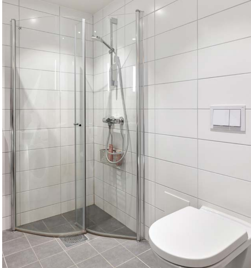
Dusjhjørne med innfellbare glassvegger og vegghengt toalett.
