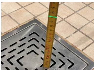
Fallforhold ca. 140 mm topp slukrist i dusjsone
