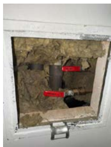
Inspeksjonsluke med stoppekraner
