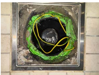
Plastsluk fra byggeår
