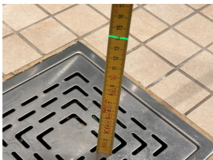
Fallforhold ca. 140 mm topp slukrist i dusjsone
