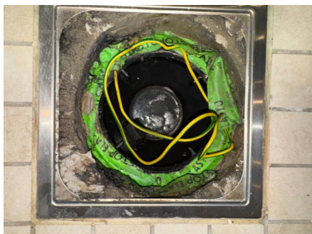
Plastsluk fra byggeår
