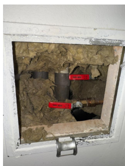
Inspeksjonsluke med stoppekraner
