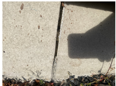
Bilde viser ufaglig skjøt mellom ringmurselementer.
