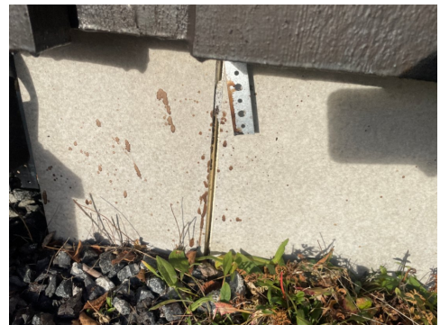
Bilde viser ufaglig skjøt mellom ringmurselementer.
