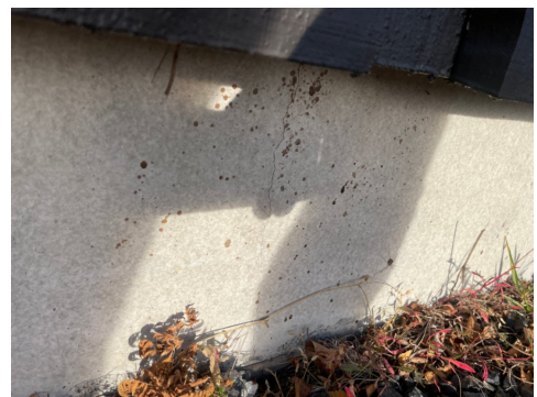
Bilde viser riss i overflate
