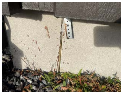
Bilde viser ufaglig skjøt mellom ringmurselementer.
