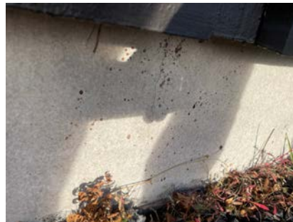
Bilde viser riss i overflate
