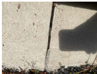
Bilde viser ufaglig skjøt mellom ringmurselementer.
