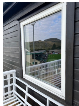
Vinduer med slitasje og symptomer med råteskader
