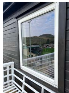
Vinduer med slitasje og symptomer med råteskader
