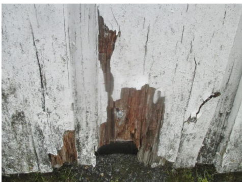
Råteskader endevegg i mot terrasse over garasje.
