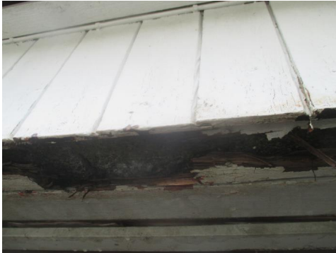
Råteskader i rundt porter og over porter.
