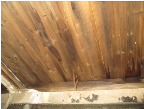
Fukt og kondensmerker i garasjen.
