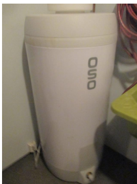
Nyere bereder på vaskerommet til hoveddelen.
