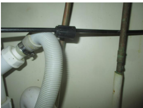
Deler av vannrør.
