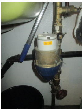
Innvendig stoppekran med vannmåler på vaskerommet.
