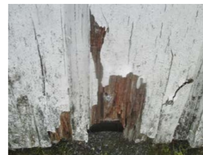
Råteskader endevegg i mot terrasse over garasje.
