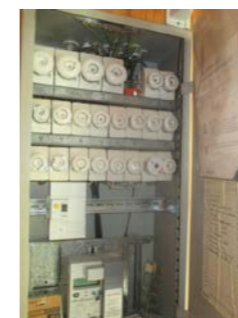
Sikringsskapet til hoveddelen.
