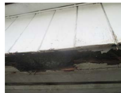
Råteskader i rundt porter og over porter.
