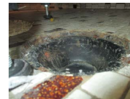
Usikker tetting i rundt sluk.
