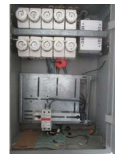
Sikringsskapet til utleiedelen.
