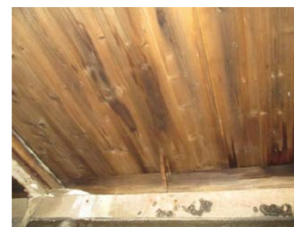
Fukt og kondensmerker i garasjen.
