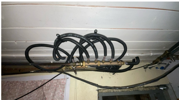
Vannfordeling til bad 1. etasje, mangler merking
