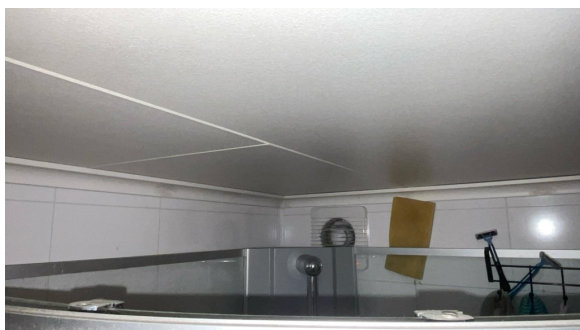
Mekanisk avtrekk på vegg
