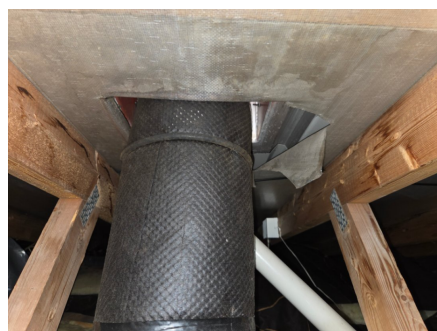
Manglende mansjett på undertak ved gjennomføringer
