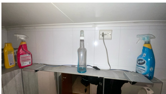
Lys over speilskap må kontrolleres
