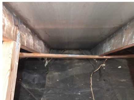
Ventilering er begrenset mot raft
