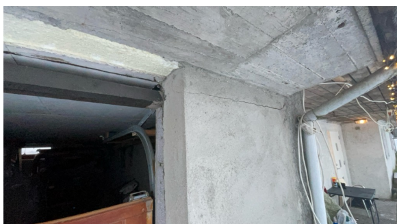
Sprekk i mur ved garasje.
