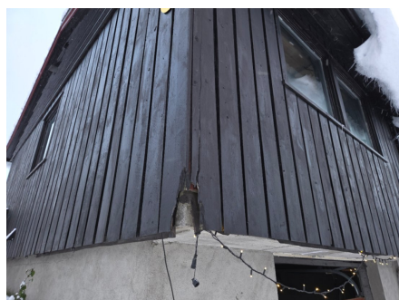
Skade på hjørnebord, må byttes
