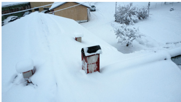
Pipehatt og luftehatt
