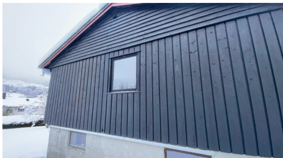
Gavelvegg med behov for utbedring
