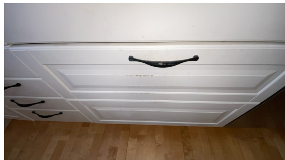
Svelling/skade på kjøkkenfront under vask
