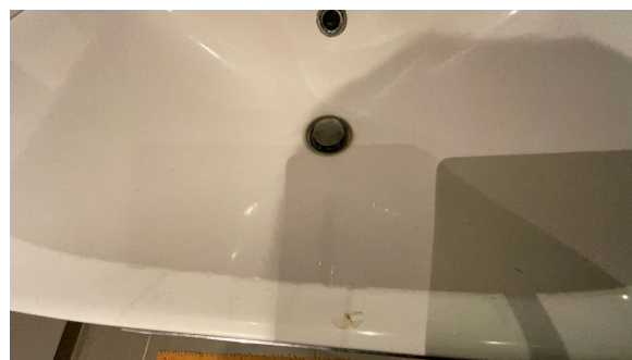
Skade i servant, tett med fugemasse
