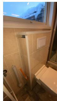
Sideplater på vegghegt toalett er løsnet.
