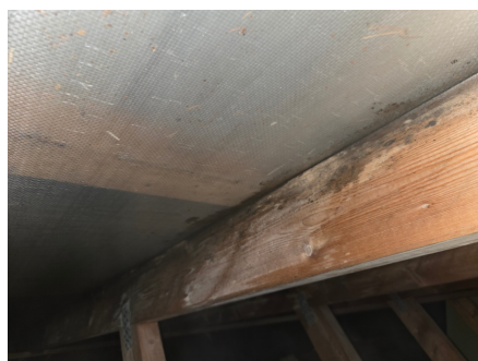
Fuktmerker på takstoler grunnet plast undertak
