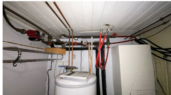
Fordeling av varme og sirkulasjonspumper
