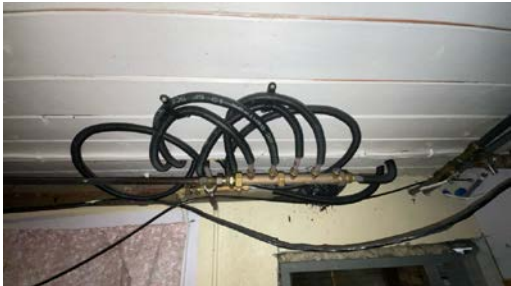
Vannfordeling til bad 1. etasje, mangler merking
