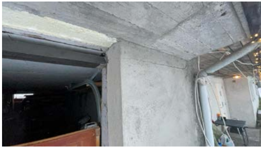
Sprekk i mur ved garasje.
