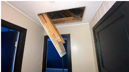
Uisolert loftsluke med stige i gang
