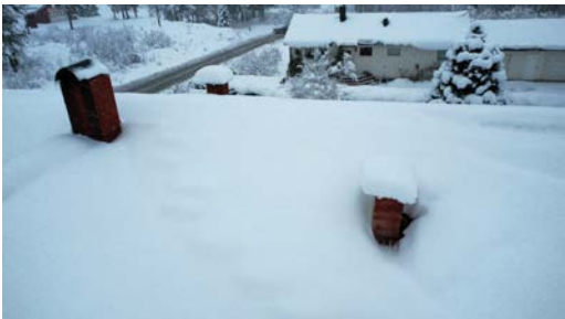
Pipehatt og luftehatt
