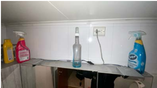
Lys over speilskap må kontrolleres
