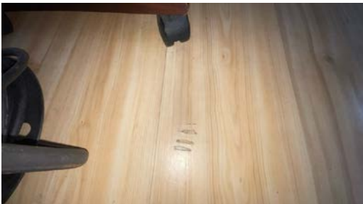
Overflateskader på kjøkkengulv
