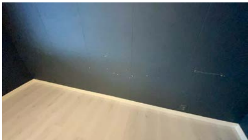
Overflateskader på veggplater soverom 2
