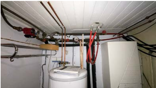
Fordeling av varme og sirkulasjonspumper
