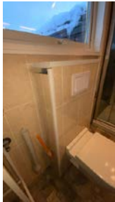
Sideplater på vegghengt toalett er løsnet.
