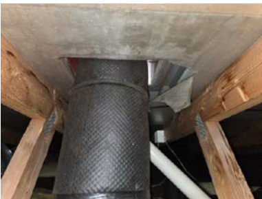
Manglende mansjett på undertak ved gjennomføringer
