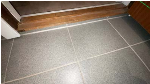
Dørterskel er hevet for å ivareta vannsikkerheten
