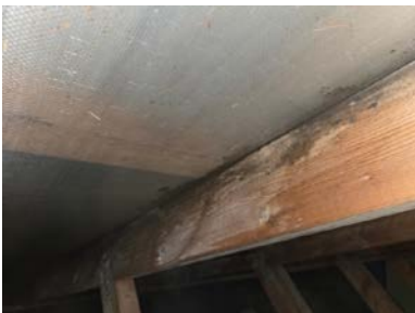
Fuktmerker på takstoler grunnet plast undertak
