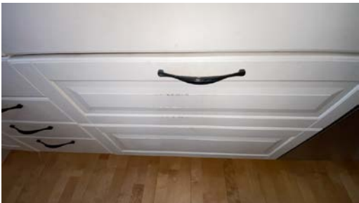
Svelling/skade på kjøkkenfront under vask
