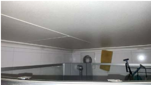
Mekanisk avtrekk på vegg
