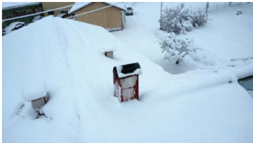
Pipehatt og luftehatt
