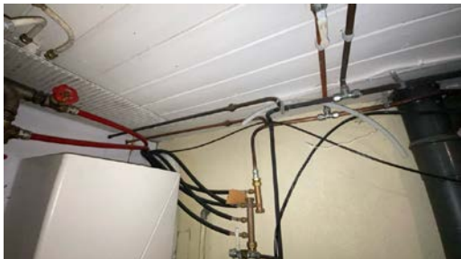
Åpne rør i himling teknisk rom
