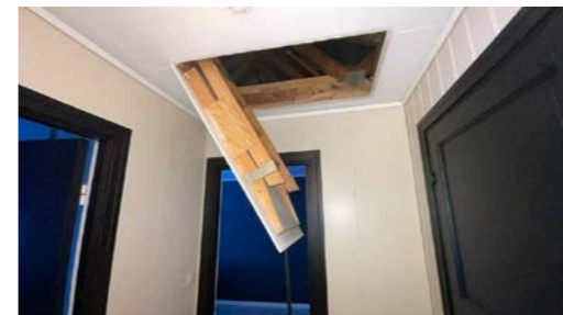
Uisolert loftsluke med stige i gang
