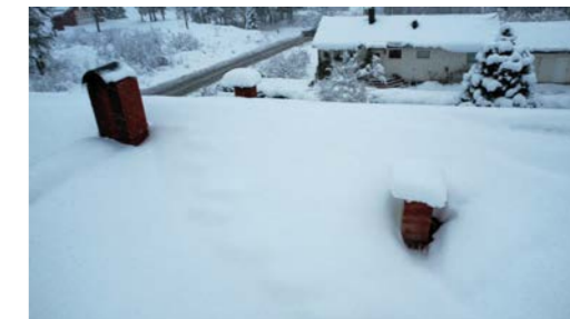
Pipehatt og luftehatt
