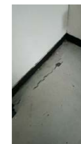
Det er noe avskalling av maling på gulv.
