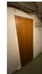
Dør til gang sett fra teknisk rom bolig.
