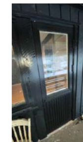
Balkongdør fra soverom fra byggeår. Døra er vanskelig å lukke gunnet feil justering
