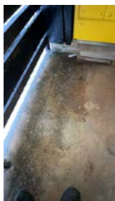
Svikt i gulv like ved inngang til garasje verksted som tyder på råte i undergulv
