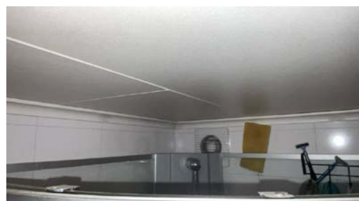
Mekanisk avtrekk på vegg
