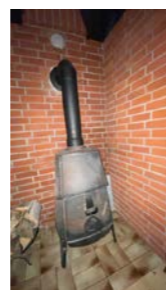
Vedovn i underetasje, det er montert varmefordelings vifte opp til 1. etasje i etasjeskiller. Det bør monteres pakning på dør.
