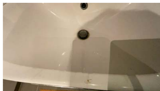
Skade i servant, tett med fugemasse
