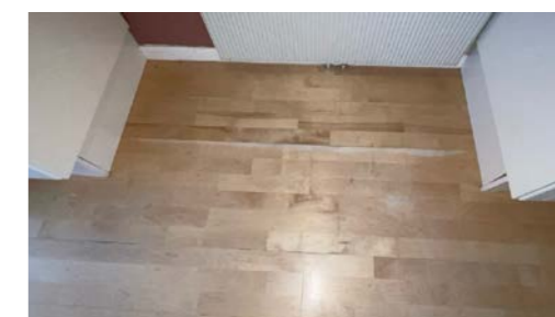
Slitasje på kjøkkengulv ved benk og svelling i skjøt
