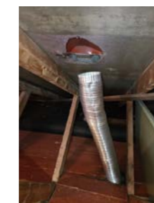
Avtrekksrør er ikke ført tilstrekkelig opp i avtrekshette på tak og mangler isolering
