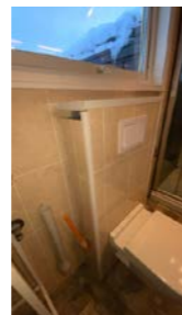
Sideplater på vegghengt toalett er løsnet.
