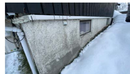
Oversikt, mur har behov for vask og overflatebehandling
