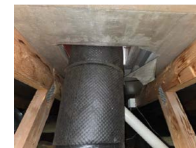
Manglende mansjett på undertak ved gjennomføringer
