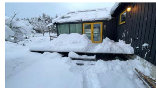
Mangler rekkverk ved trapp og inngang. Høyde fra terreng er målt til 65 cm.
