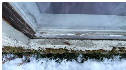
Vinduer som er montert i mur mangler beslag og kan ha skjulte skader med råte bak puss
