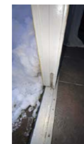
Mangler låsing på dobbeltdør mot terskel. Den bør monteres for å sikre tilstrekkelig tetthet.
