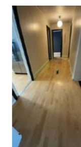
1. etasje Plassering av laser ved kontroll av gang. Det er målt 8 mm høydeforskjell gjennom rommet. TG 1.
