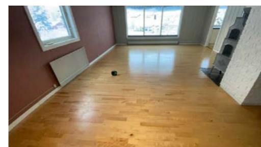
1. etasje Plassering av laser ved kontroll av stue. Det er målt 14 mm høydeforskjell gjennom rommet. TG 1
