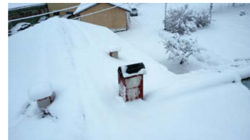
Pipehatt og luftehatt
