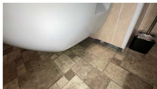
Mangler sokkel/belegg mellom gulv og veggplater på toalett.
