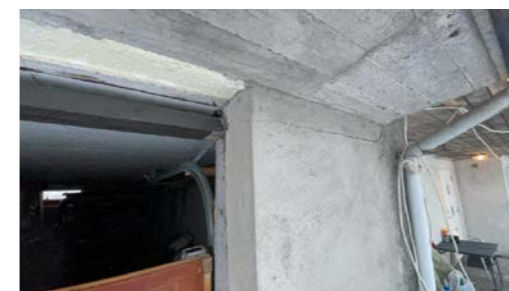
Sprekk i mur ved garasje.
