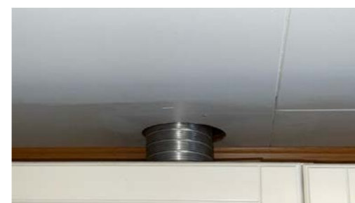
Mangler tetting rundt ventilatorrør opp på kryploftet over ventilatorskap.
