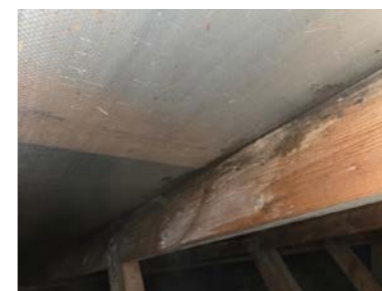
Fuktmerker på takstoler grunnet plast undertak
