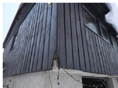
Skade på hjørnebord, må byttes
