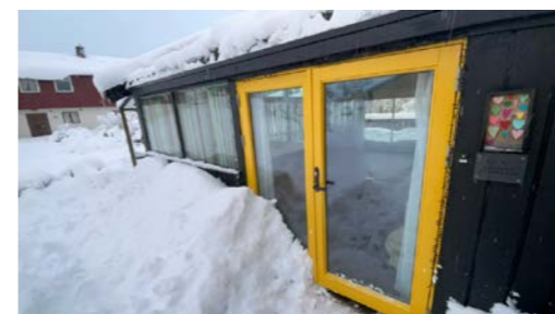
Hoveddør fra 2016. Mangler låsing på dobbeltdør mot terskel. Den bør monteres for å sikre tilstrekkelig tetthet.
