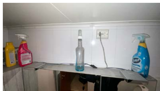
Lys over speilskap må kontrolleres
