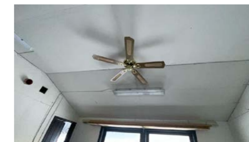
Overganger i himling er ikke sparklet ferdig mellom flat og skrå himling
