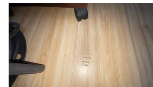
Overflateskader på kjøkkengulv
