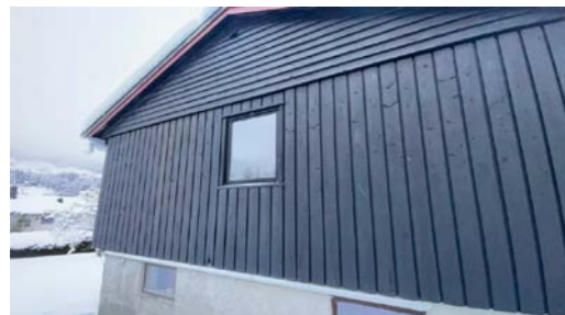
Gavelvegg med behov for utbedring
