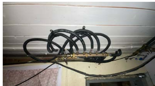
Vannfordeling til bad 1. etasje, mangler merking
