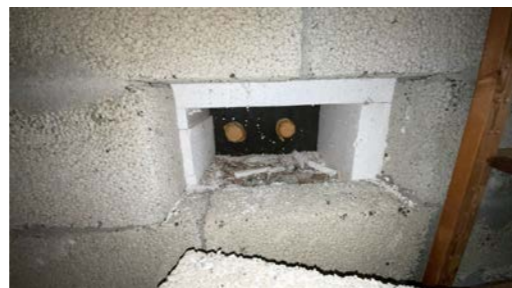
Rør inn på tank er skjult bak stein i lagerrom
