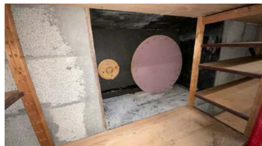
Åpning mot tank er tilgjengelig fra lagerrom. Tank er ikke kontrollert
