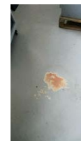
Det er noe misfarging av maling på gulv.
