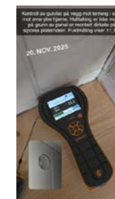
Kontroll av gulvlist på vegg mot terreng i stue mot øvre hjørne. Hulltaking er ikke mulig på grunn av panel er montert dirkete på siporex plater/stein. Fuktmåling viser 11,1%
