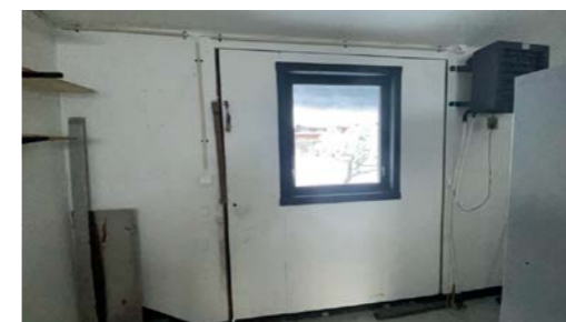
Deler av vegg/dør som tas ut for tilkomst fra utsiden er ikke tett
