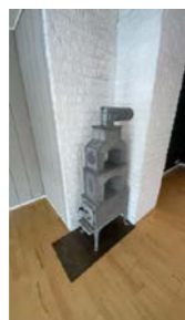
Vedovn på stue i 1. etasje, pakning på dør bør utbedres
