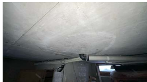
Synlig eldre fuktsvelling i brannsikre plater ved rørgjennomføring til sluk
