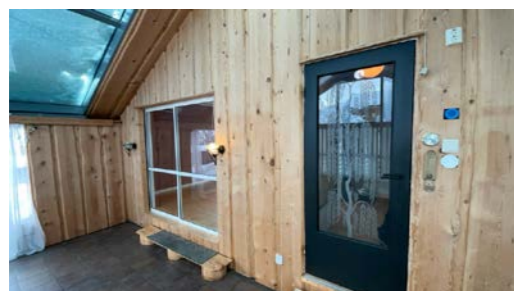
Skyvedør mellom hagestue og stue. Dør til gang tar i terskel
