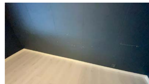
Overflateskader på veggplater soverom 2
