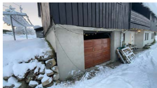
Oversikt, synlig at port element ikke er montert
