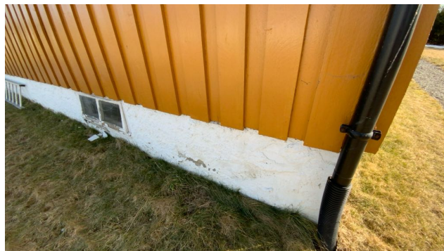
Stedvis behov for lokale utbedringer.
