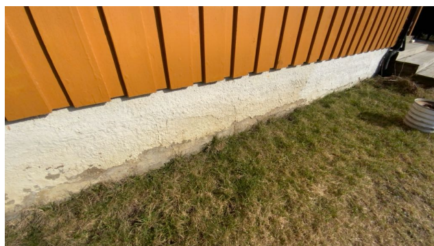
Stedvis behov for lokale utbedringer.
