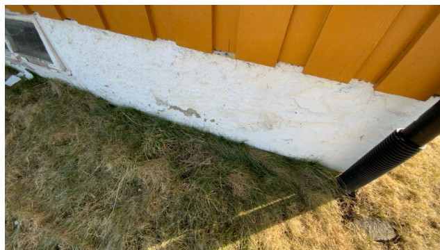
Stedvis behov for lokale utbedringer.
