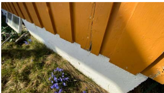
Stedvis behov for lokale utbedringer.
