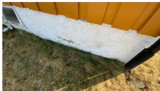
Stedvis behov for lokale utbedringer.
