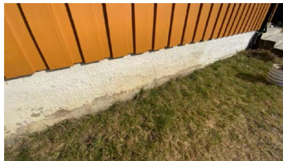
Stedvis behov for lokale utbedringer.
