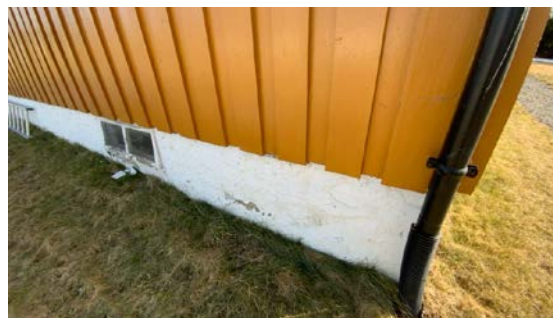
Stedvis behov for lokale utbedringer.
