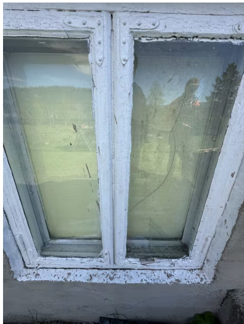
Sprekk i rute
