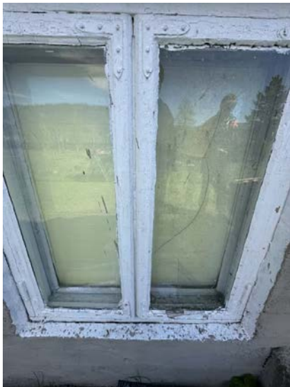
Sprekk i rute
