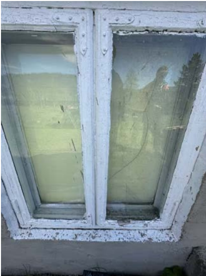
Sprekk i rute
