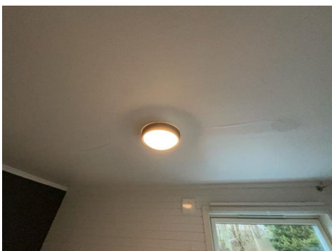
Sprekk i papphimling på soverom.
