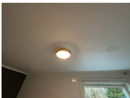
Sprekk i papphimling på soverom.
