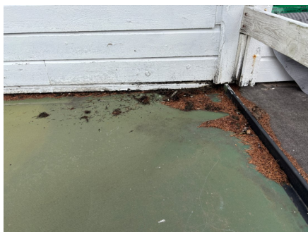
Kledning er avsluttet mot balkongdekke
