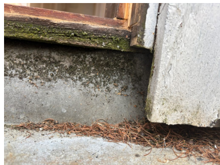
Balkongdør i 2. etasje har slitasje
