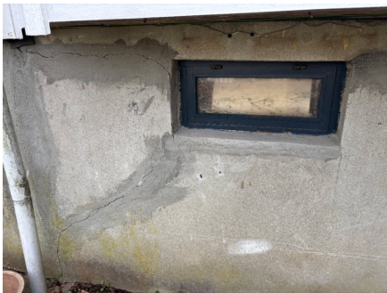
Det er påvist setningsrelaterte skader i grunnmuren, herunder riss og sprekkdannelse. I tillegg er det synlige støpeskjøter.
