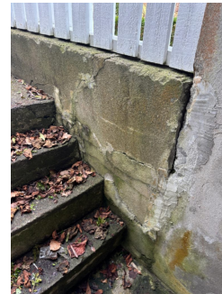
Det er påvist setningsrelaterte skader i grunnmuren/murvange, herunder riss og sprekkdannelse.
