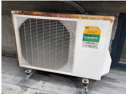
Utedelen til varmepumpe har rustskader
