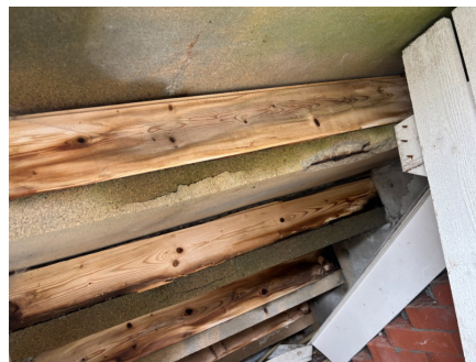
Betongtrapp har avskalling i betongkonstruksjon
