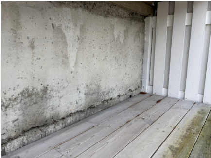
Det er synlige støpeskjøter i grunnmuren.
