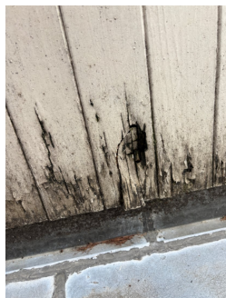
Kledning på balkonger har slitasje/råte
