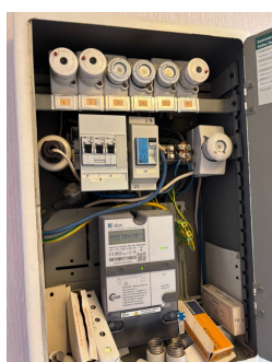
Sikringskap er med automat og skrusikringer
