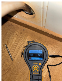
Fuktkvotemåling (vekt%) i konstruksjonen ble målt til 24,3
