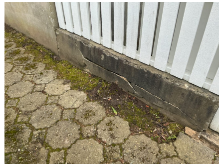
Det er påvist setningsrelaterte skader i grunnmuren/murvange, herunder riss og sprekkdannelse. I tillegg er det synlige støpeskjøter.
