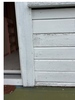
Kledning er avsluttet mot balkongdekke
