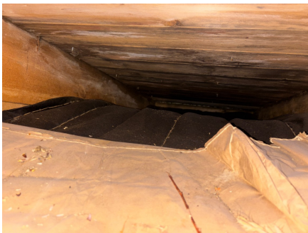
Undertaket i tre har misfarging
