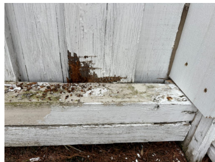
Kledning på balkonger har slitasje/råte
