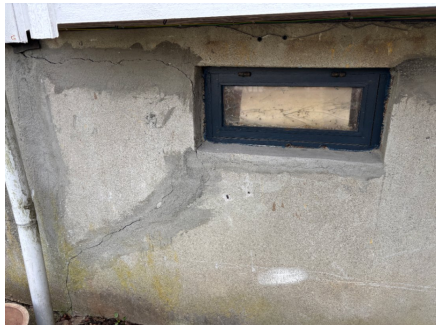
Vindu med enkelt glass er sprukket
