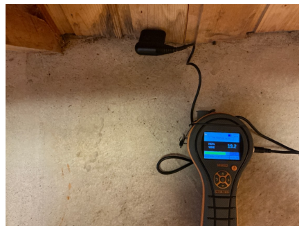
Fuktkvotemåling (vekt%) i panel med misfarging ble målt til 19,2
