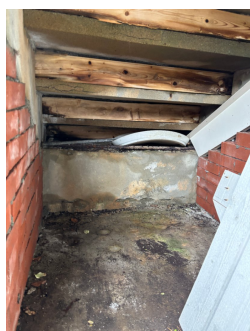
Betongtrapp har avskalling i betongkonstruksjon
