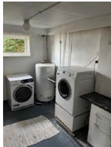
Varmtvannsbereder er lokalisert i vaskerommet i kjelleren
