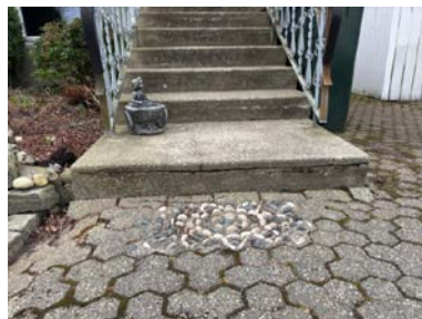
Betongtrapp har sprekker og riss
