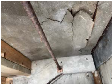
Betongtrapp har avskalling i betongkonstruksjon
