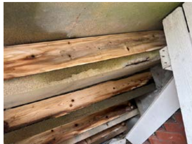
Betongtrapp har avskalling i betongkonstruksjon
