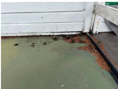
Kledning er avsluttet mot balkongdekke
