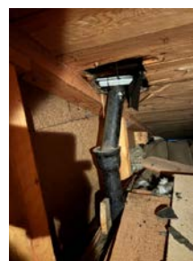
Takgjennomføringer i taket må utbedres for å redusere risiko for lekkasjer.
