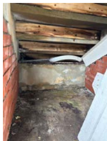
Betongtrapp har avskalling i betongkonstruksjon
