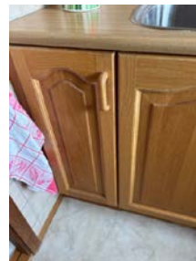
Det er påvist slitasje på innredning
