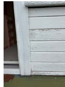
Kledning er avsluttet mot balkongdekke
