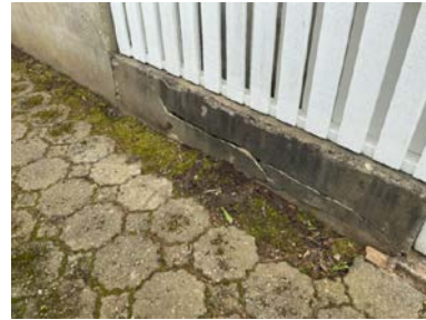
Det er påvist setningsrelaterte skader i grunnmuren/murvange, herunder riss og sprekkdannelser. I tillegg er det synlige støpeskjøter.
