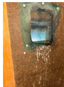
Veggventil må sikres mot fugler
