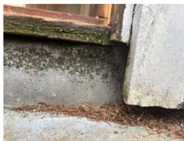
Balkongdør i 2. etasje har slitasje
