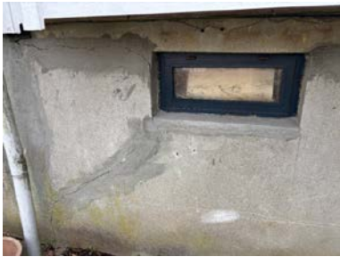
Det er påvist setningsrelaterte skader i grunnmuren, herunder riss og sprekkdannelser. I tillegg er det synlige støpeskjøter.
