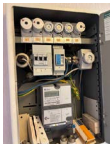
Sikringskap er med automat og skrusikringer
