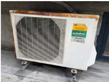
Utedelen til varmepumpe har rustskader
