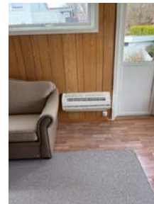
Varmepumpe er lokalisert i stuen
