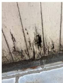
Kledning på balkonger har slitasje/råte
