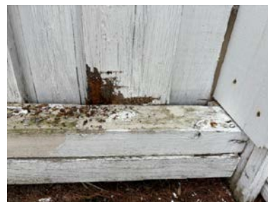
Kledning på balkonger har slitasje/råte
