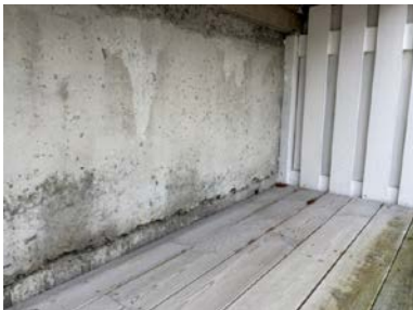
Det er synlige støpeskjøter i grunnmuren.
