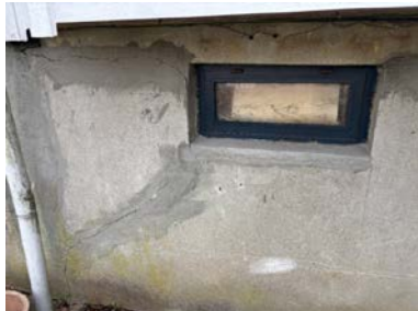
Vindu med enkelt glass er sprukket
