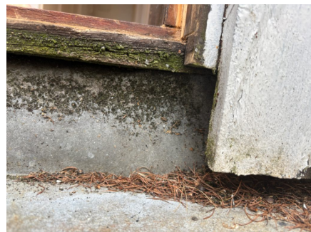
Balkongdør i 2. etasje har slitasje
