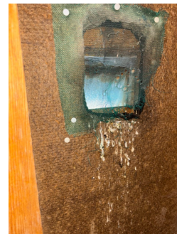
Veggventil må sikres mot fugler
