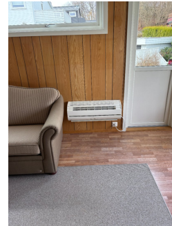
Varmepumpe er lokalisert i stuen
