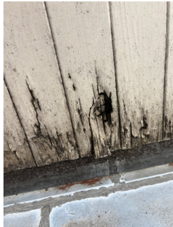
Kledning på balkonger har slitasje/råte
