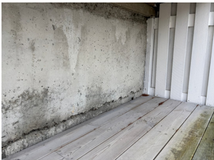
Det er synlige støpeskjøter i grunnmuren.
