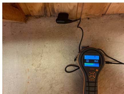
Fuktkvotemåling (vekt%) i panel med misfarging ble målt til 19,2
