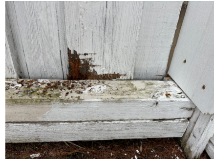
Kledning på balkonger har slitasje/råte
