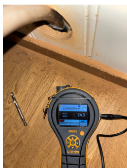
Fuktkvotemåling (vekt%) i konstruksjonen ble målt til 24,3
