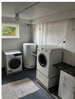
Varmtvannsbereder er lokalisert i vaskerommet i kjelleren
