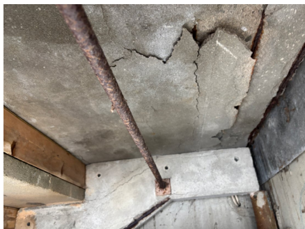
Betongtrapp har avskalling i betongkonstruksjon
