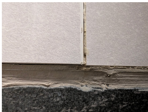
Vertikal sprekk baderomsplater
