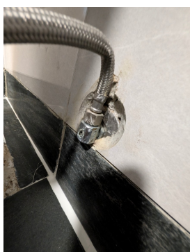
Hulltaking mangelfull håndverksmessig utførelse.
