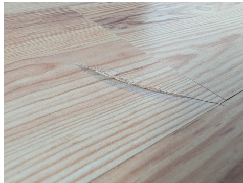
Gulv soverom med skade
