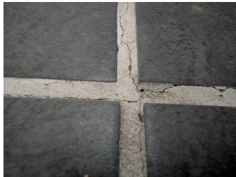
Fliser entrè med bom, riss og sprekker i fuger
