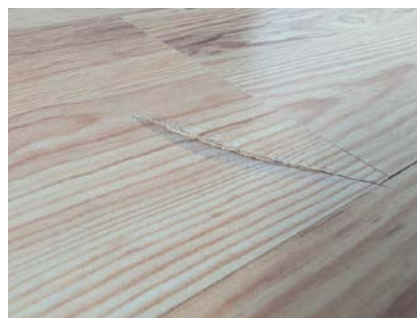
Gulv soverom med skade
