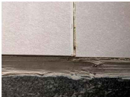
Vertikal sprekk baderomsplater
