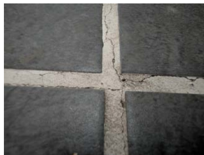
Fliser entrè med bom, riss og sprekker i fuger
