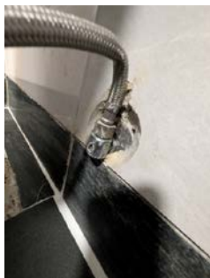
Hulltaking mangelfull håndverksmessig utførelse.
