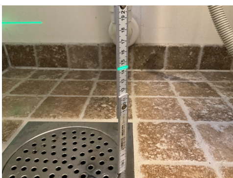
Fall på gulv ble målt til 10 mm.
