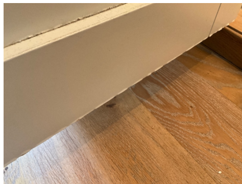
Påbegynt svelleskade på dørblad på bad.
