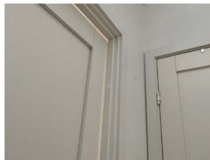
Eksempel på dør som må ettertrekkes ved lukking.
