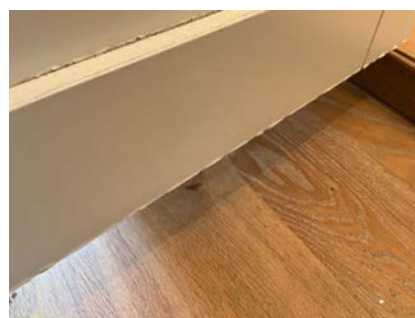
Påbegynt svelleskade på dørrblad på bad.
