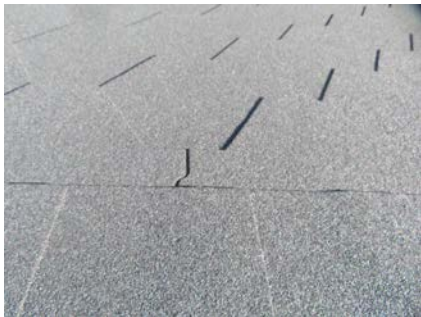
Det er ikke lagt shingel helt opp og under mønepanne.
