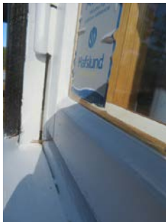
Ikke tett mellom vannbrett og vindu samt mot sidebord.
