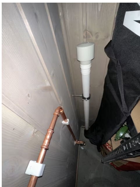
Kloakk er ikke luftet over tak. Lufting med vakumventil i bod med utvendig adkomst.
