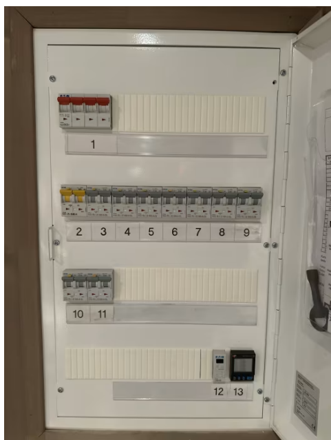
Viser innfelt sikringsskap plassert i gang.
