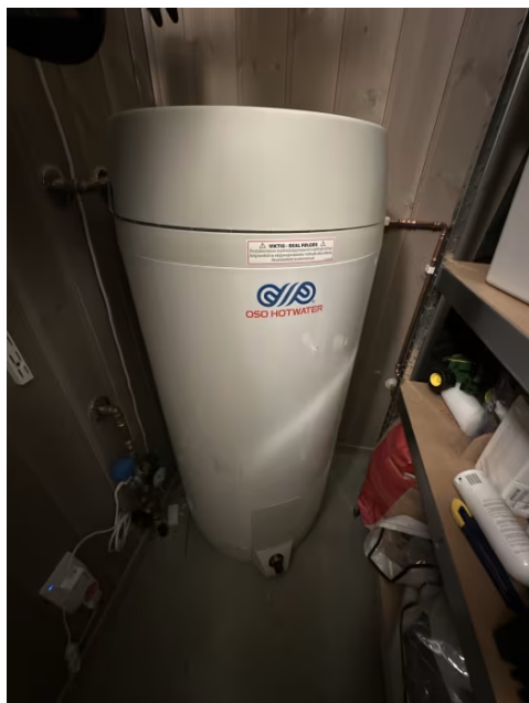
Viser bereder plassert i bod.
