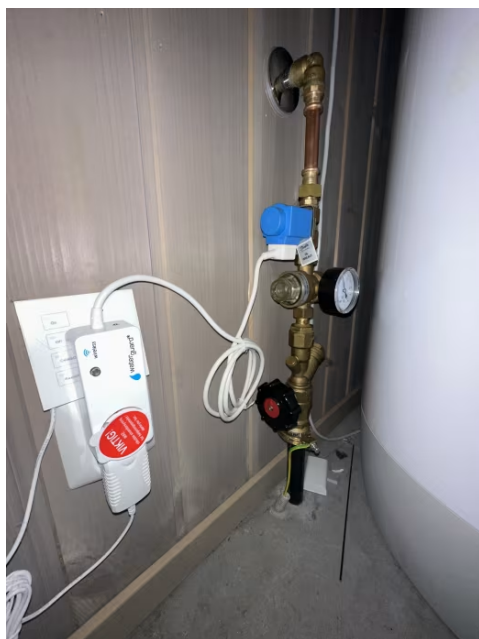
Vanninntak, hovedstoppekran og water guard plassert i bod med utvendig adkomst.
