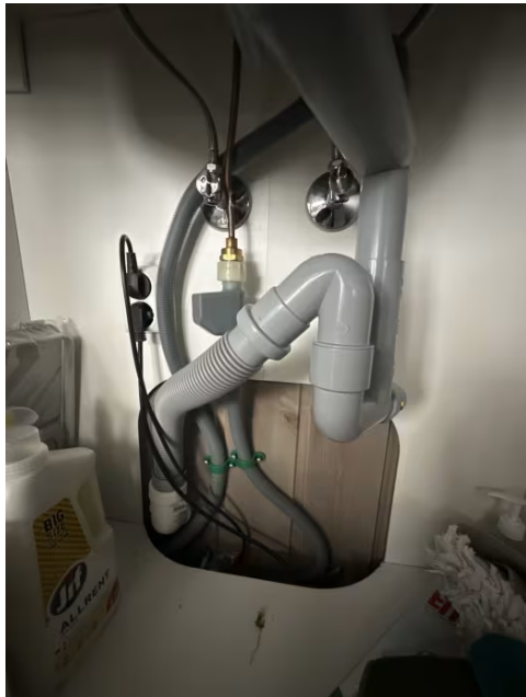
Viser vann og avløpsinnstallasjoner under kum.
