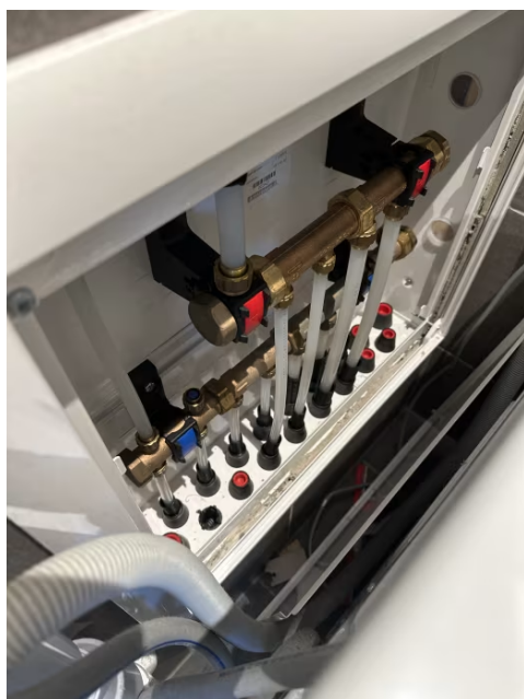
Viser vannrør med rør i rør system fra fordelerskap plassert på bad og frem til sanitærinstallasjoner på baderom, toalettrom og kjøkken.
