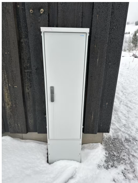
Viser utvendig målerskap.
