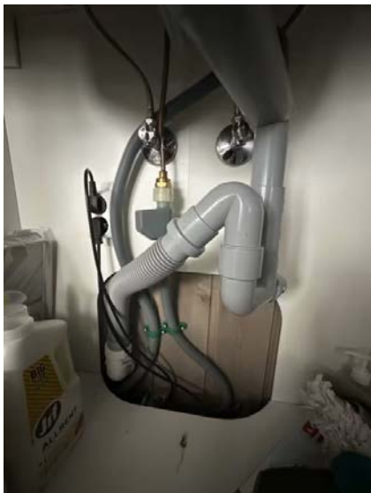
Viser vann og avløpsinnstallasjoner under kum.
