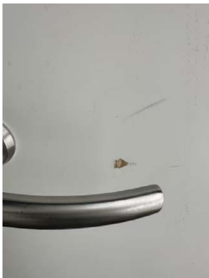
Registrert mindre hakk i dørblad til bod.
