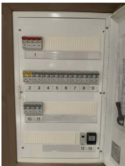
Viser innfelt sikringskap plassert i gang.
