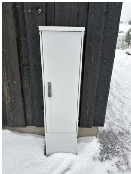
Viser utvendig målerskap.
