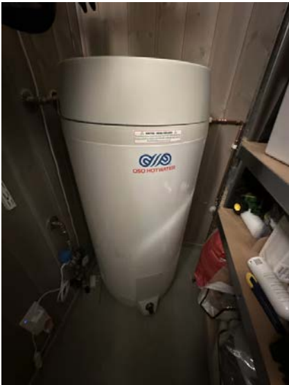
Viser bereder plassert i bod.
