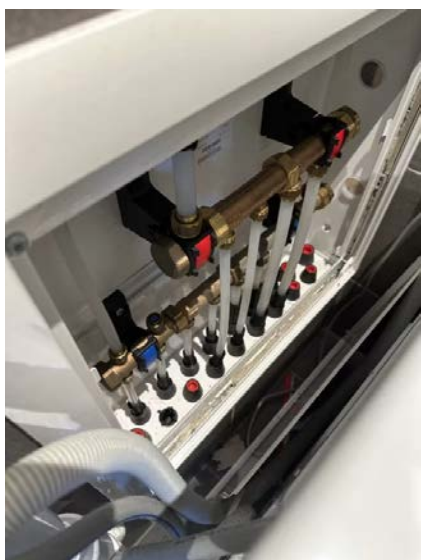
Viser vannrør med rør i rør system fra fordelerskap plassert på bad og frem til sanitærinstallasjoner på baderom, toalettrom og kjøkken.
