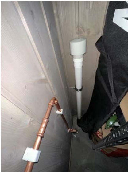
Kloakk er ikke luftet over tak. Lufting med vakumventil i bod med utvendig adkomst.
