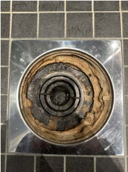
Viser sluk i dusjsonen.
