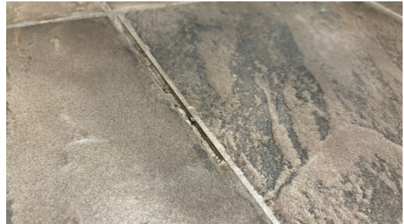
Skader i enkelte flisfuger
