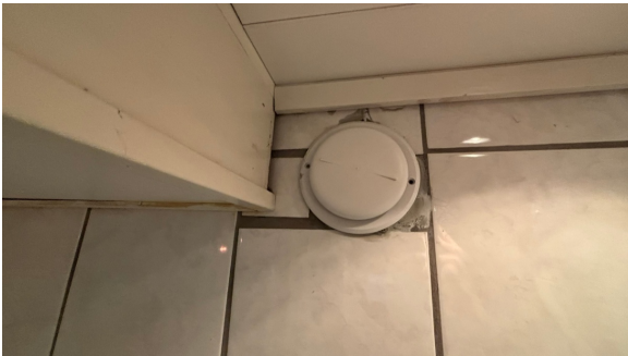
Uheldig utførelse ved flislegging
