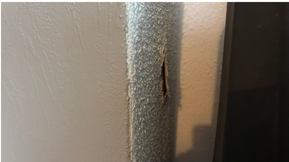
Skader i overflaten ved ovnen
