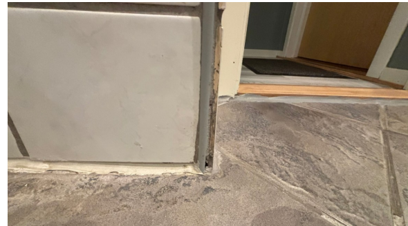
Uheldig utførelse ved flislegging
