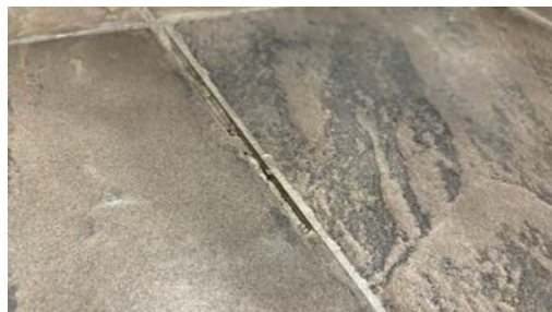
Skader i enkelte flisfuger
