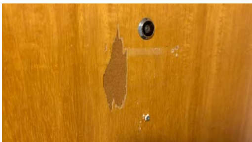
Skade i overflaten på ytterdøren
