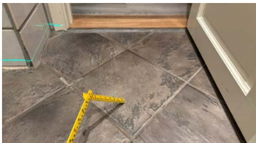
Det er registrert bomlyd på flisene i dette området
