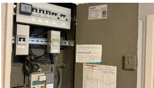
Sikringsskap i fellesareal
