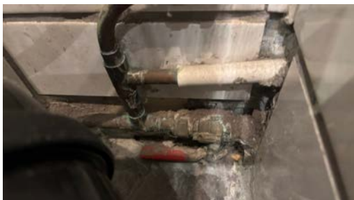
Grønn irr ved hovedstoppekranen
