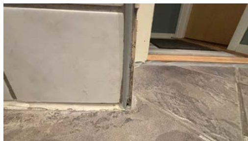
Uheldig utførelse ved flislegging
