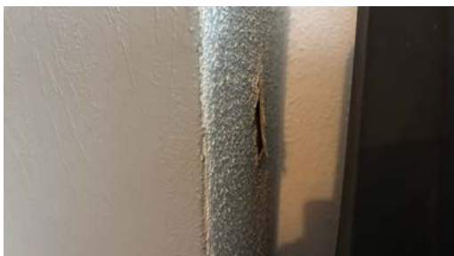
Skader i overflaten ved ovnen
