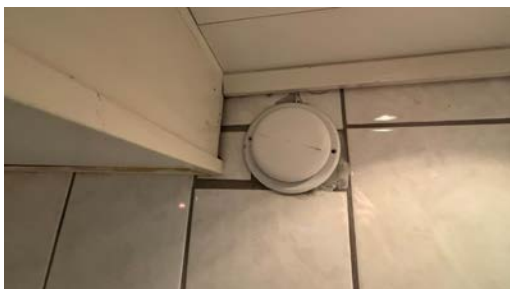
Uheldig utførelse ved flislegging
